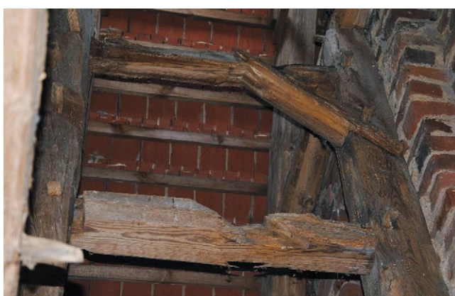
Rys. 8. Rozszczerzone połączenia elementów ścianki stolcowo-ryglowej
