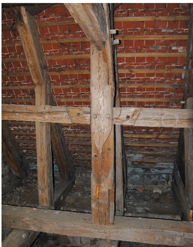
Rys. 9. Miejsca po usuniętych zastrzałach
