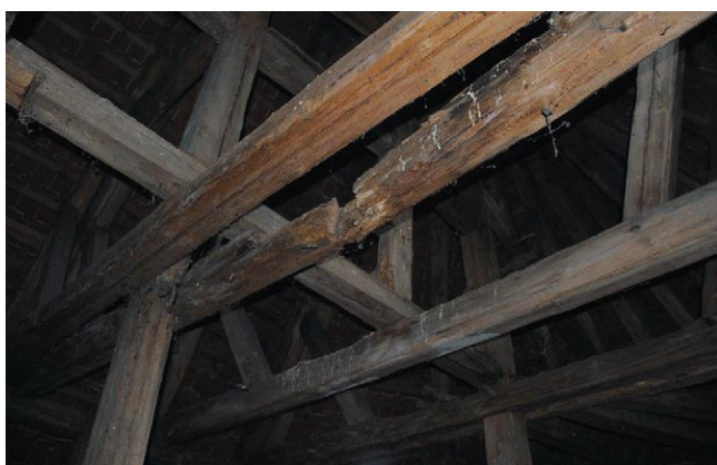
Rys. 13. Miejsce po usunięciu słupie, korozja biologiczna jętki
