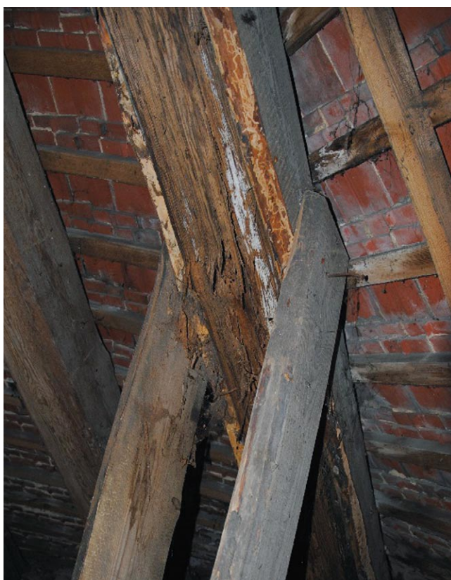
Rys. 10. Skorodowana krokiew wtórnie wzmocniona nadbitkami
