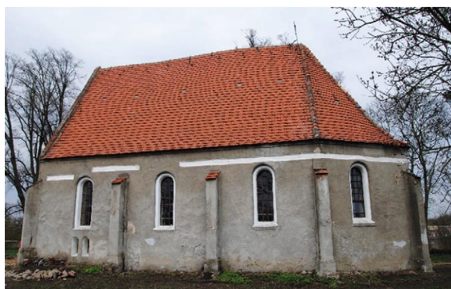
Rys. 1. Widok kościoła od strony południowej; ugięcia kalenicy, odkształcenia połaci dachowej
