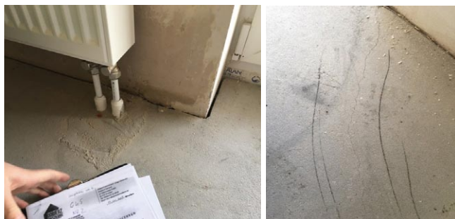
Rys. 1. Przykład wady polegającej na pęknięciu posadzki i braku równości jej powierzchni (źródło własne)
