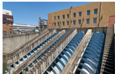
老朽化対策をしている雨水スクリープンプ
